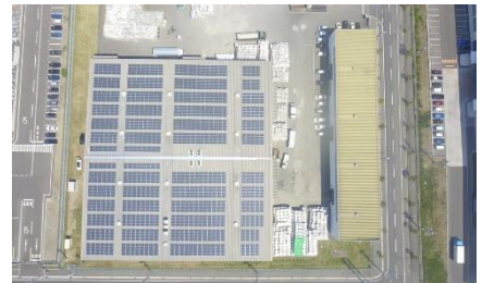
（写真）屋根上設置型 397.28KW [宮城県多賀城市]
