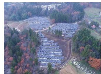
（写真）野立設置型 990.00KW [岩手県奥州市]
